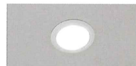
照明 LEDダウンライト(4000K)を標準で2個設置しており、室内を明るく照らします。
