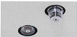
スプリンクラー 天井には熱感知式の消火装置を設置しています。
